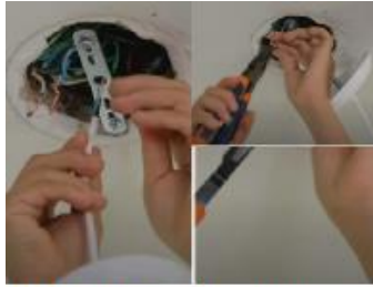
FIGURA (2) FAÇA A LIGAÇÃO DOS FIOS GERALMENTE SÃO DOIS PASSANDO POR DENTRO DA TRAVESSA. *FIO FASE *FIO NEUTRO
